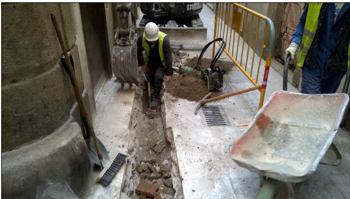
Fotografia 6. Excavació manual del tram final de la rasa al carrer de la Seca
